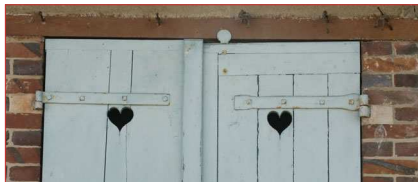
Jour de ventilation en forme de cœur
