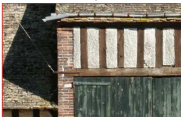
Colombages protégés par un lait de chaux.
