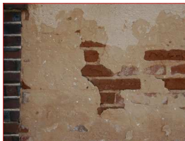
Ancien enduit ocre rouge et brique.
